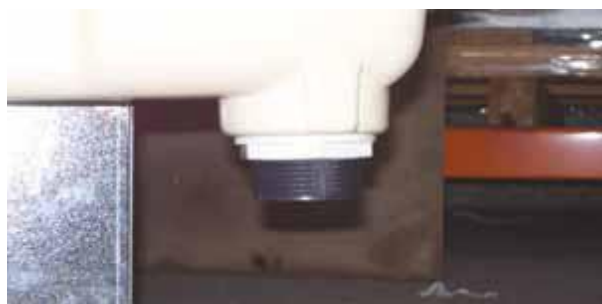
Zařízení na vypouštění vody
