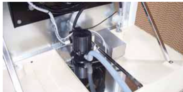
Obrázek 5.2 Recirkulační čerpadlo a distribuce vody
